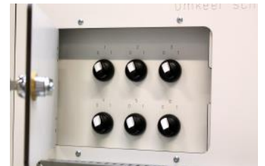
Foutenschakelaars achter afsluitbaar deurtje
